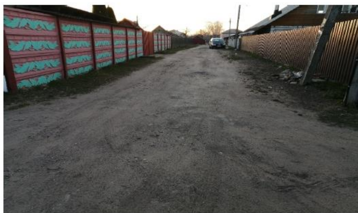
Рис. 1. Грунтовая дорога с дефектами покрытия в г. Могилеве, пер. Нефтяной
