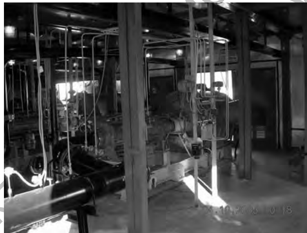
Рис. 4. Насосные агрегаты ГДМ8-03-125/750-400 в НПУ «РИТЭК Белоярскнефть»
