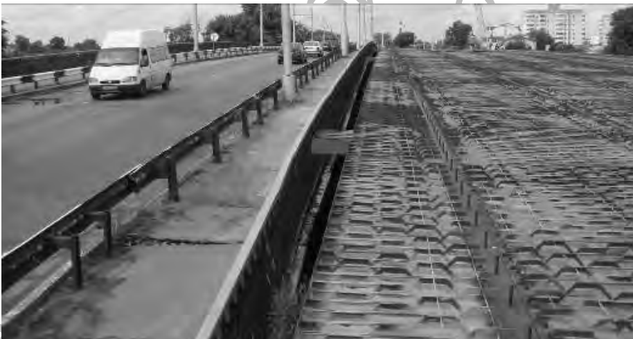
Рис. 5. Фрагмент мостового полотна: а – общий вид; б – первая очередь реконструкции путепровода по ул. Полесской в г. Гомеле (правая часть фото)
