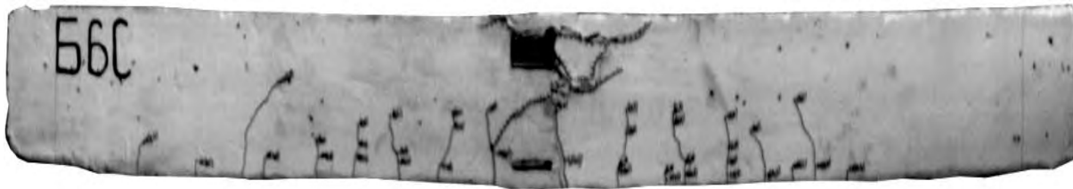
Рис. 4. Характер трещинообразования усиленных балок БУ: а – сторона А; б – сторона Б
