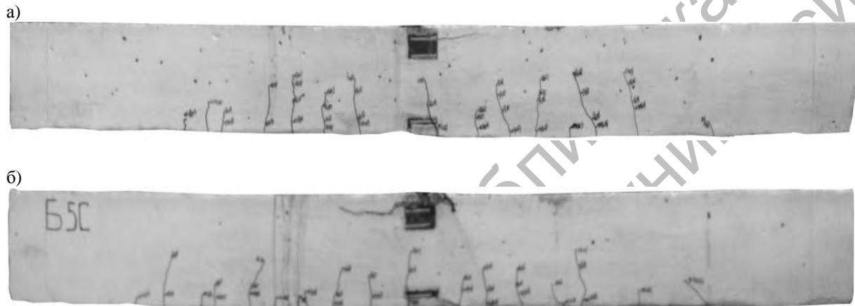
Рис. 5. Характер трещинообразования усиленных (восстановленных) балок БВ: а – сторона А; б – сторона Б
