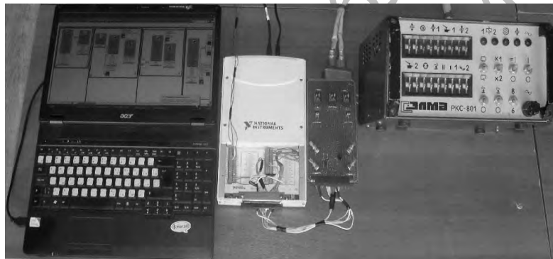
Рис. 3. Аппаратура системы автоматического управления процессом контактной рельефной сварки
