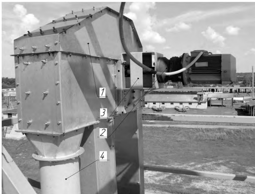
Рис. 10. Общий вид привода ковшового элеватора: 1 – норийная голова; 2 – мотор-редуктор; 3 – рама привода; 4 – разгрузочный патрубок
