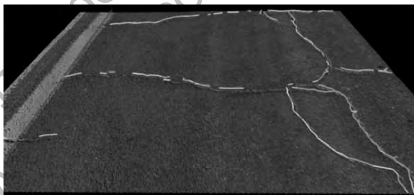
Рис. 2. Изображение поверхности покрытия, полученное с применением системы лазерного определения дефектов LCMS™ канадской компании «Пэйвметрикс» (Pavemetrics)
