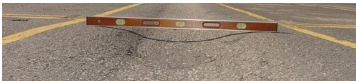
Рис. 1. Дорожное покрытие требующее ремонта
