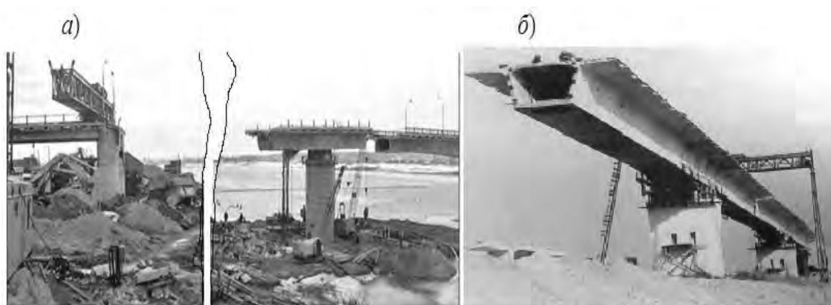
Рис. 1. Разрушение моста с проезжей частью коробчатого сечения: а – общий вид; б – фрагмент
