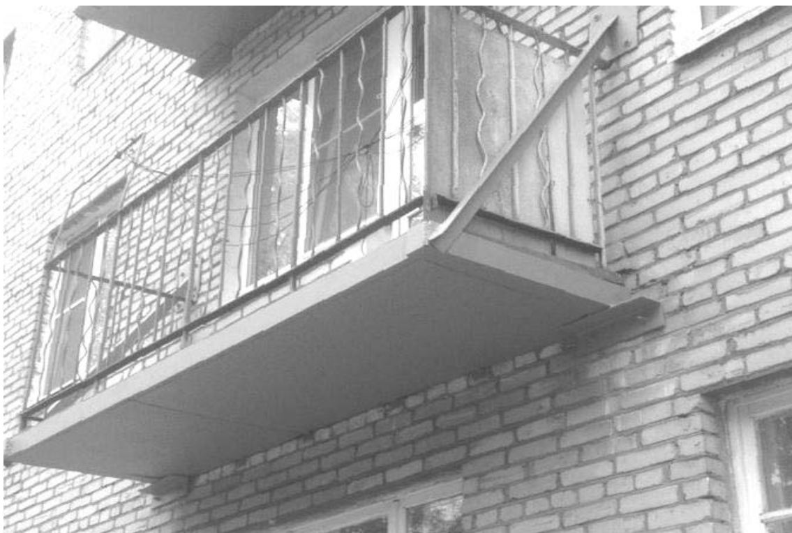
Рисунок Д.5 – Пример усиления и восстановления балконных плит стальными элементами сверху (III категория технического состояния)
