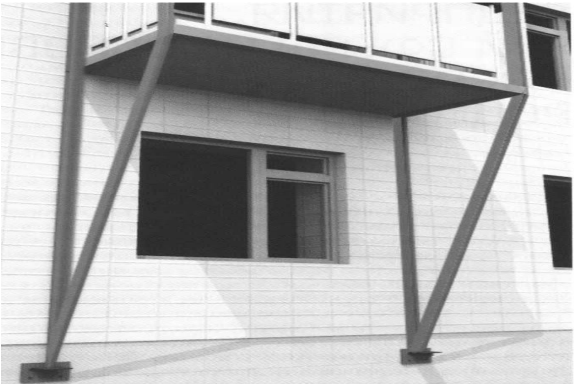
Рисунок Д.3 – Пример усиления и восстановления балконных плит стальными элементами снизу (IV категория технического состояния)
