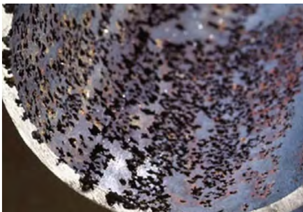
Рис. 1 б Внутренняя питтинговая коррозия
