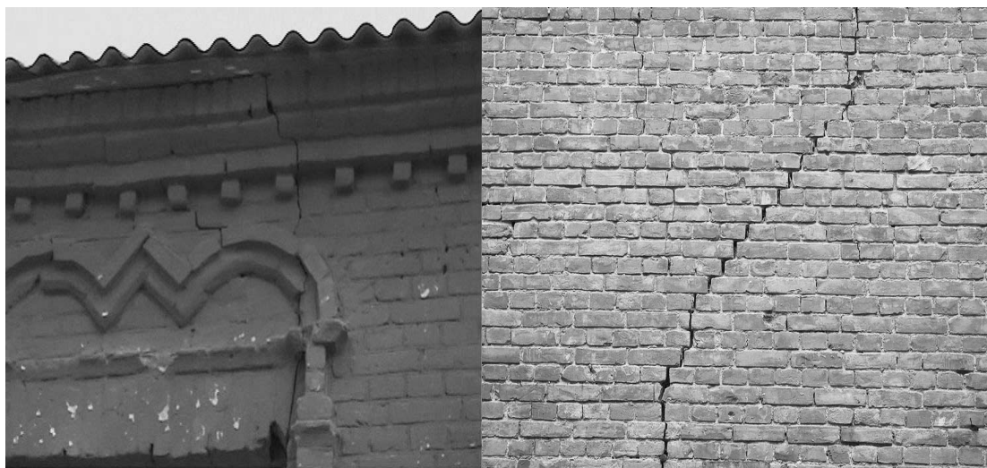
Рисунок 1.1 – Трещина в стене
