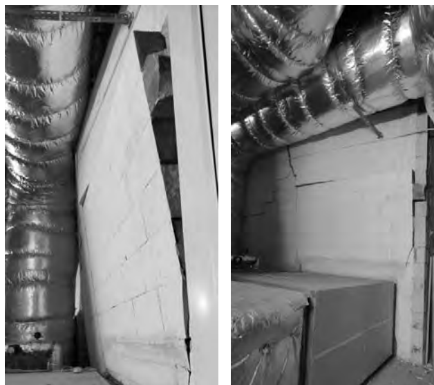
Рис. 1. Виды на поврежденное в результате урагана внутреннее стеновое ограждение воздухозаборной камеры
