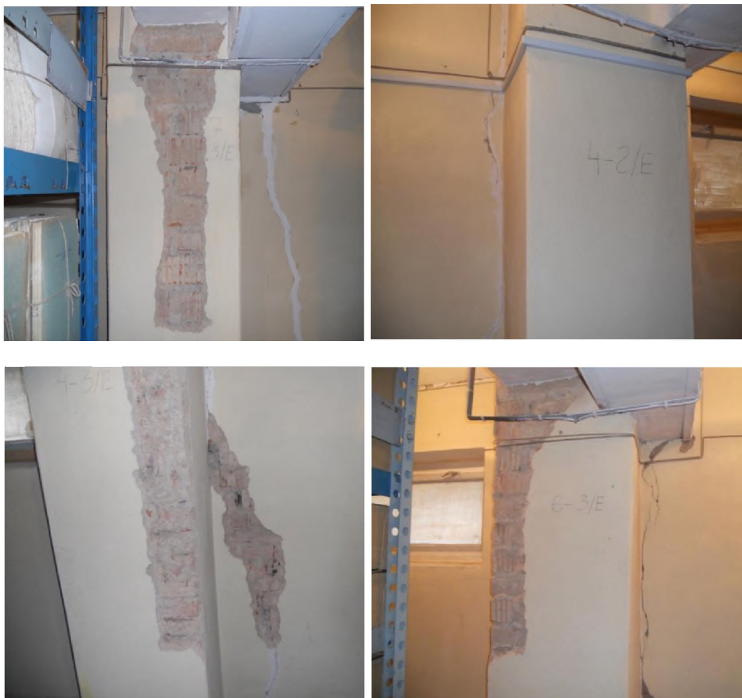
Рисунок 2 - Виды на сквозные трещины в местах сопряжения каменных пилястр с наружной стеной на разных этажах здания архива
