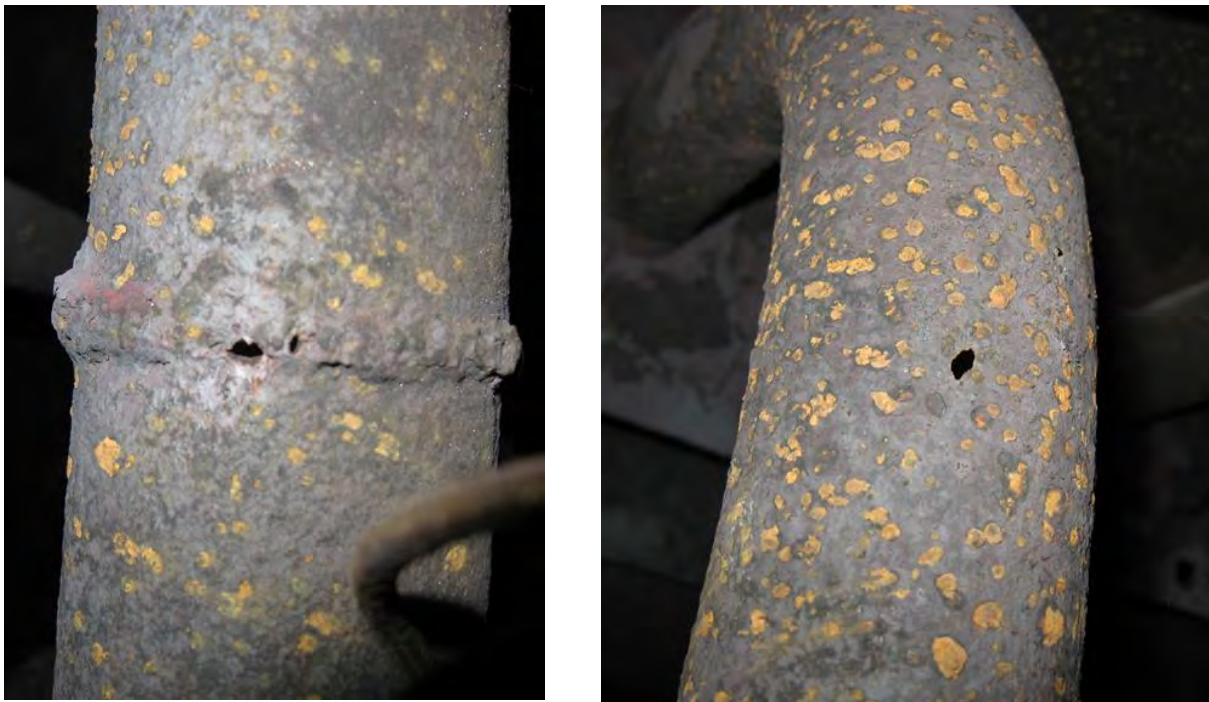
Рис. 3. Свищи, выявленные при контроле металла котла ТП-35 (–Б”) во время капитального ремонта (15 лет эксплуатации)
