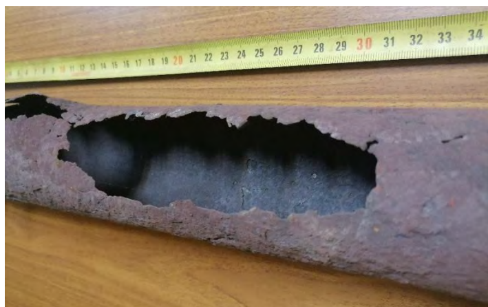
Рис. 4. Сквозное повреждение внутри барабанной трубы выявленное при контроле металла котла ТП-35 (–В”) во время кап. ремонта при наработке 25 лет
