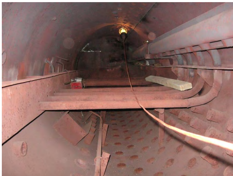
Рис. 2. Внутри барабанные питательные трубы Ø60x4 мм (сталь 20) котла ТП-35 (–А”) (после демонтажа сепарационных устройств)
