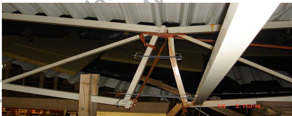
Рис. 1. Разрыв нижнего пояса стропильной фермы
