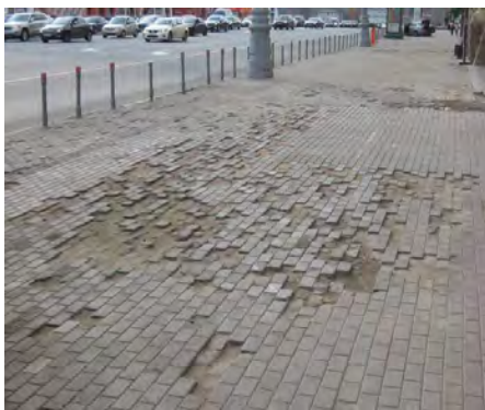
Рис. 1. Разрушенное тротуарное покрытие
